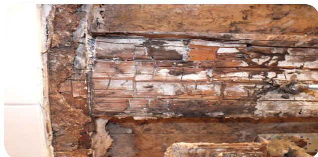
Ein vom Hausschwamm befallener Balken
